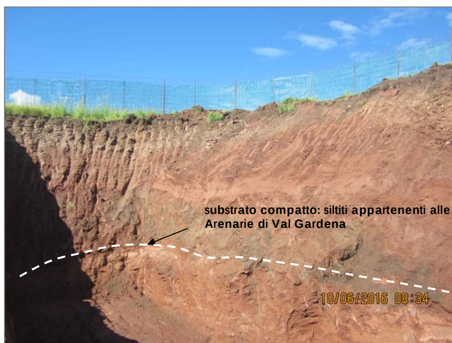
Fig.3. terreni sciolti in corrispondenza dello scavo a monte della rotatoria
